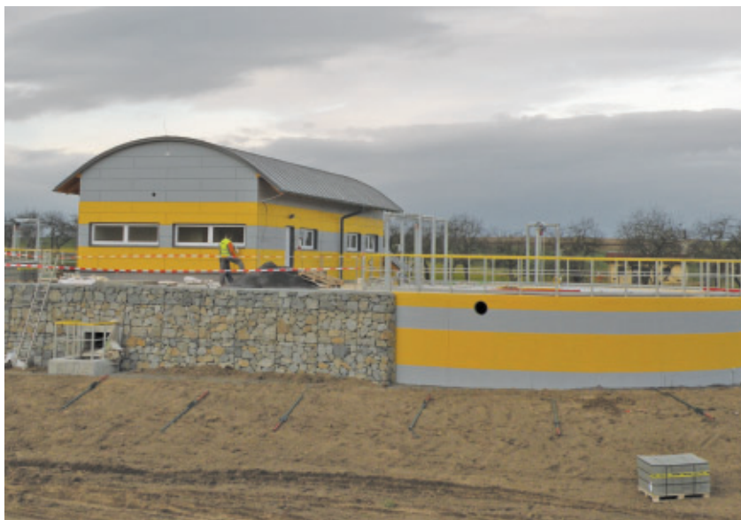
Štěpánkovice - Čistírna odpadních vod Štěpánkovice / Water treatment plant in Štěpánkovice
